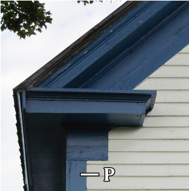
Retour de corniche et planche cornière (P) au 152, rang Amyot Ouest, Saint-Denis-sur-Richelieu.
