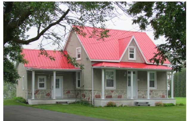
Au 413, chemin des Patriotes, Saint-Denis-sur-Richelieu, la disparition des fenêtres anciennes, des parements muraux et des garnitures de rive a entraîné une perte d'authenticité architecturale.
